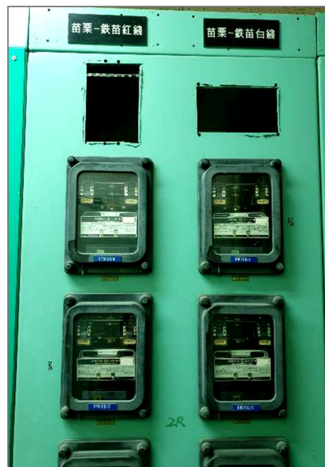
圖 5. 鐵苗紅白線 E/M 電驛盤
