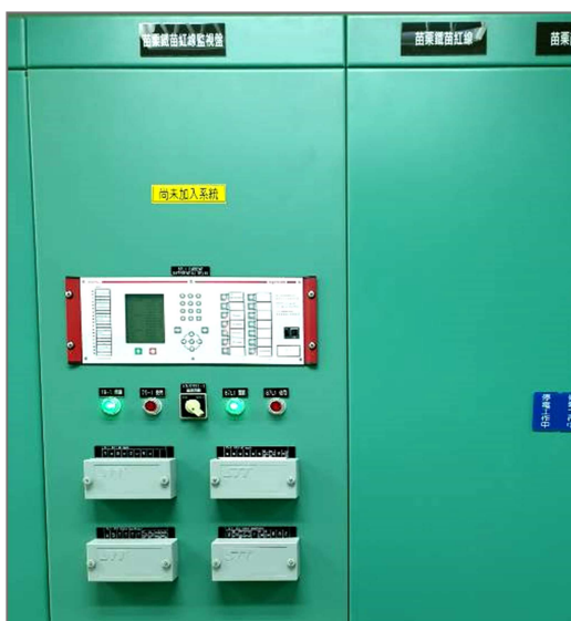
圖 9. 左為監視盤，右為 E/M 電驛盤裝設位
