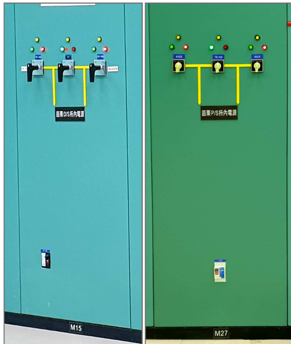
圖 12. 左為苗栗 D/S 所內電源盤 M15 右為苗栗 P/S 所內電源盤 M27
