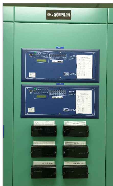
圖 11. 69kV 臨時匯流排連絡線保護電驛盤
