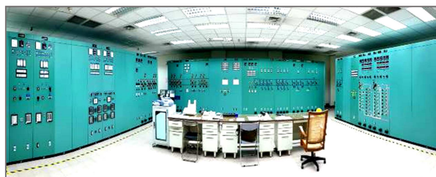
圖 3. 苗栗 D/S 4 樓控制室
