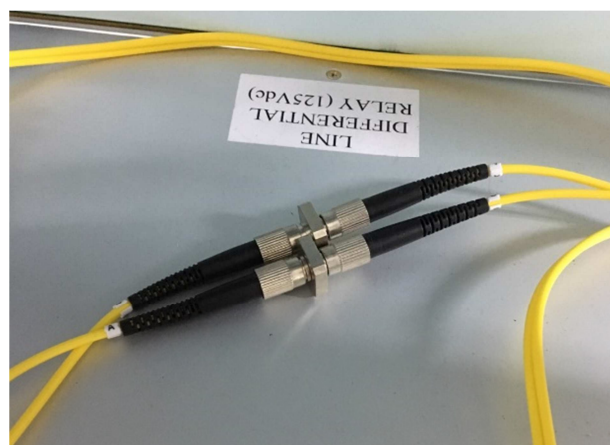
圖12 上下兩具電驛光纖TX-RX對接
