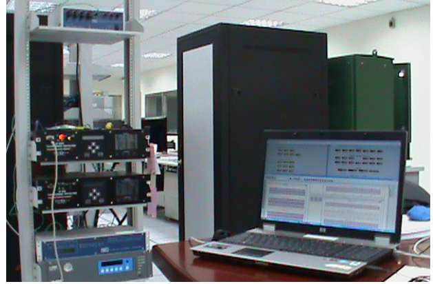
圖 12 主變壓器差動保護電驛 RTDS 動態模擬及試驗情形
